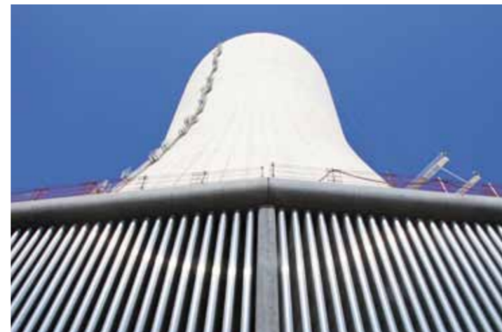
Kühlturm mit Schallschutz-Kulissen
